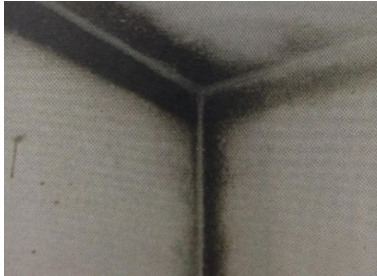
Figura 3.10: Machas de humidade em ponte térmica [Alves, et al. , 2011]
