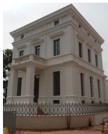
Figura 4.8: Aspeto exterior do edifício B na fase final da obra de reabilitação
