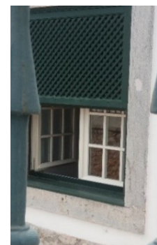
Figura 4.36: Janela com vidro duplo com corte térmico, caixilharia de madeira e guarnição pré-existente
