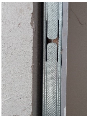
Figura 4.10: Vista em perfil do sistema de isolamento térmico aplicado
