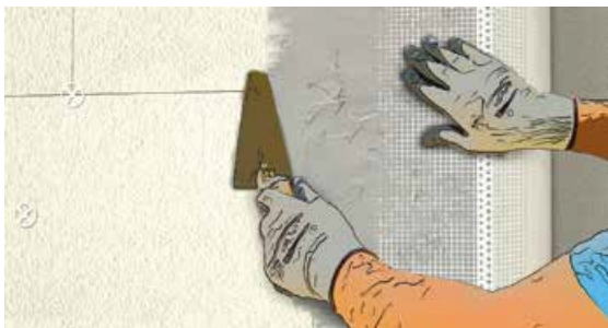
Figura 3.14: Colocação de cantoneiras de reforço nas arestas das fachadas (esquinas e contorno de vãos) [APFAC, 2015]
