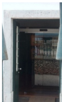
Figura 4.35: Porta principal com sistema corta-vento
